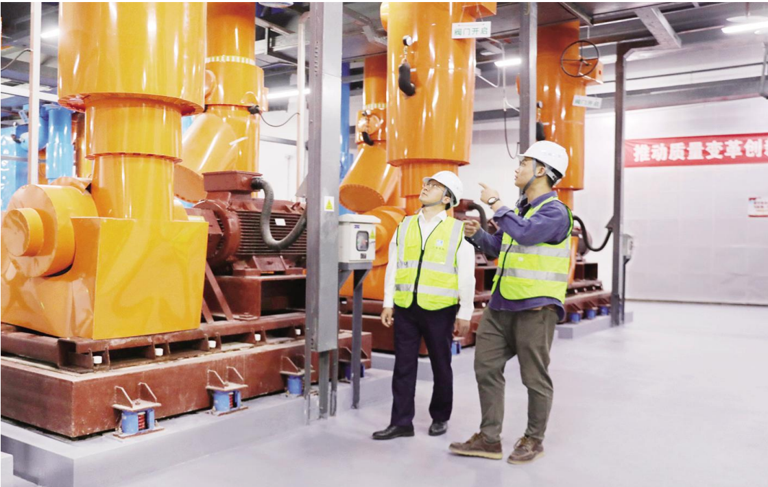
工作人员在五号冷站制冷机房检查设备运行情况。 苗威摄
