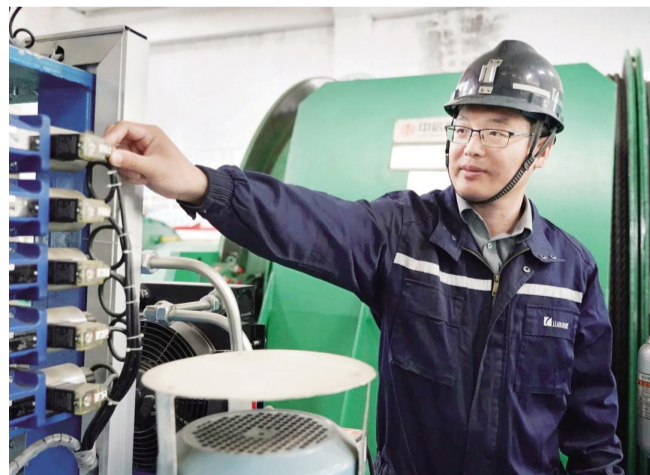
陈智慧专注检修调试设备 ■ 图片由受访者提供
