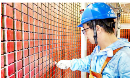
排查变电设备隐患
