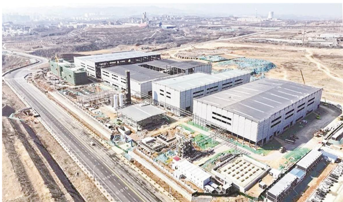
高新区泉东新材料产业园内,山西鹏博新材料年产10万吨高性能锂离子电池正极材料项目建设现场施工正酣,钢结构厂房初具规模。张哲远摄
