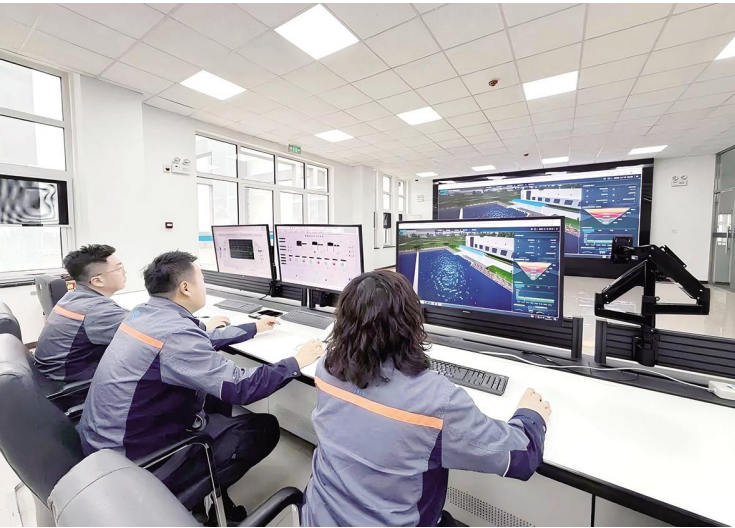
在天津市东丽区津滨水厂的中控室里,工作人员正在通过智慧大屏查看水厂状况。 徐思钰摄
