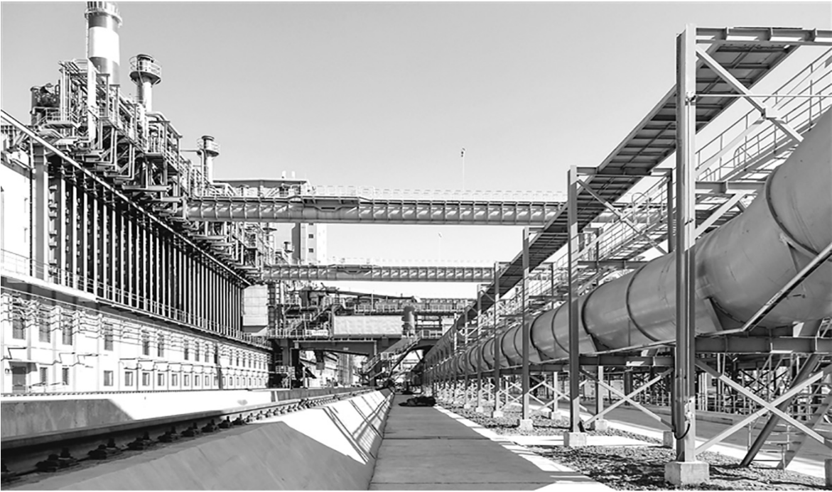
4月8日,在古县经济技术开发区的山西盛隆泰达新能源有限公司,厂区生产现场实行“无人化”作业。该公司以“5G+一键炼焦”系统为抓手,在提升数字化智能化水平的同时,引领带动产业集聚发展,推动传统产业转型升级。
