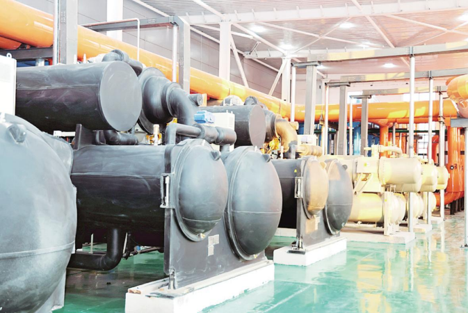
图为太重智能高端装备产业园区 3 号余热站水源热泵机组。
