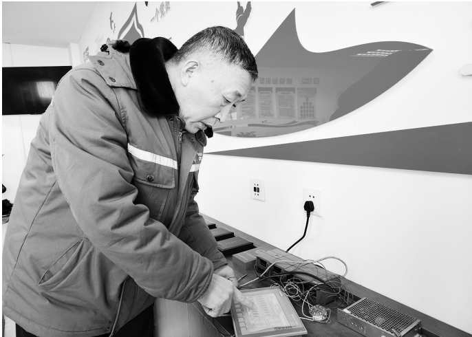
郭世江正在操作PLC控制屏
